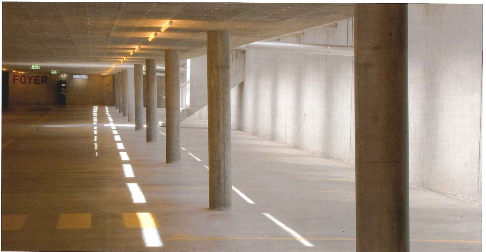
Leuchtstofflampen mit Farbfiltern beleuchten die Tiefgarage. Auch in diesem Bereich befinden sich Tageslichtöffnungen.
